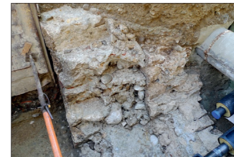
Abb. 1 Die Vormauerung der dritten Phase stösst an die Tuffmauer. Blick nach Osten.
