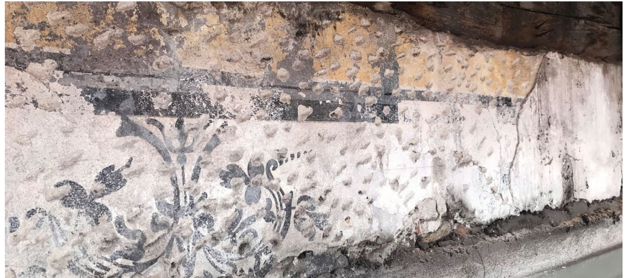
Peinture sur le haut de la façade, sous l'avant-toit.
