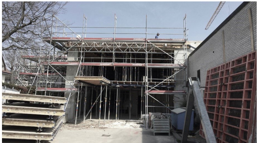
Hier entsteht der neue Haupteingang zum Längmattschulhaus. Rechts im Bild: Rückwand der Aula. (Bild: LZ&A Architekten AG)
