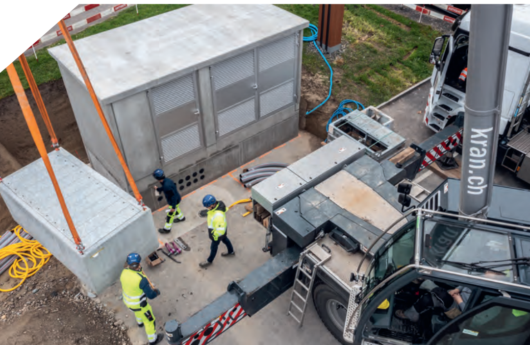
Trafo für Schnellladestation E-Mobilität
