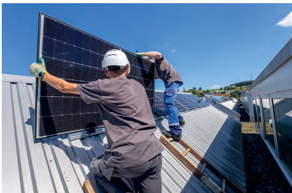
Photovoltaikanlage Orientierungsschule Region Murten
